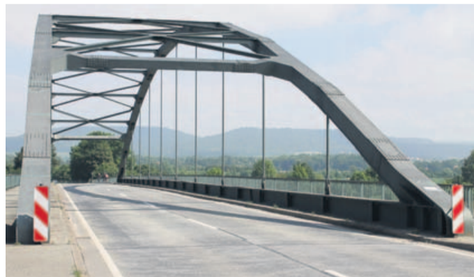
„Statisches Defizit“: Auf der Weserbrücke gilt Tempo 50.
