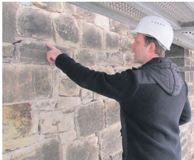
Mathias Riethmüller zeigt die rissigen Fugen im Mauerwerk.
