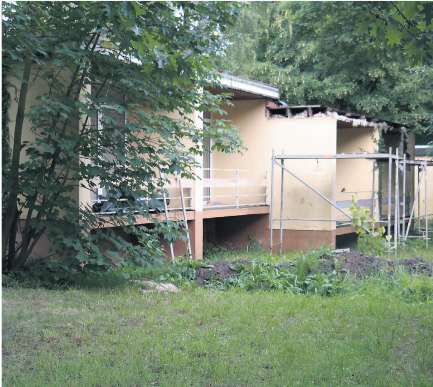
Die Bauarbeiten am ehemaligen Landschulheim in Hessisch Oldendorf haben begonnen und es gibt auch noch einiges zu tun, bis hier das Kompetenzzentrum für erneuerbare Energien der Archea Unternehmensgruppe entstehen kann. cbo
